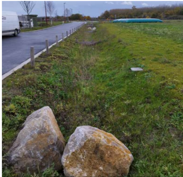
Figure 10 : Exemple de noue en long de voirie avec redents réguliers près de Tournai (photo prise par ARIES, 2022)
